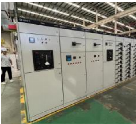
交流低压配电设备 MNS-L
