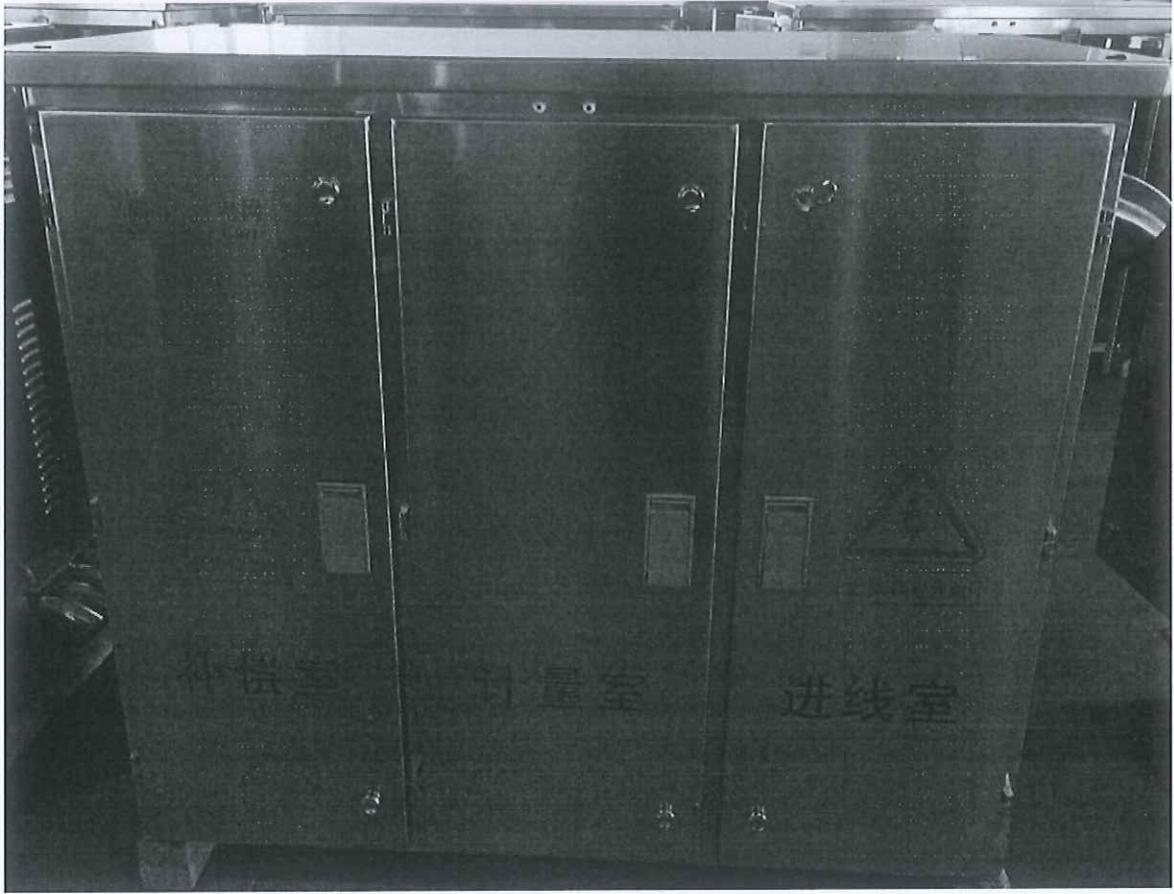
智能性低压综合配电箱 (JP)
