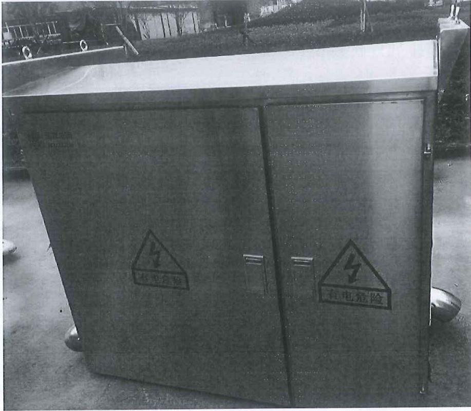
智能综合配电箱（低压成套开关设备）（JP）
