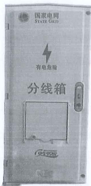
配电箱（低压分线箱）（FXX）
