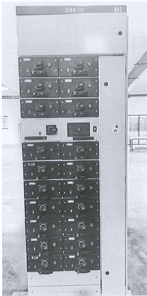
低压开关柜 (MNS)
