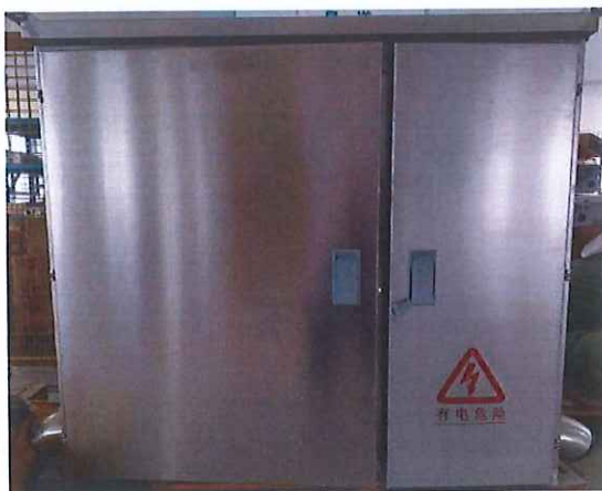
智能型综合配电箱 (JP)
