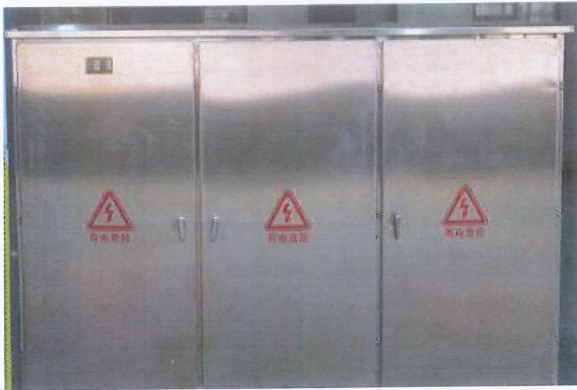
综合配电箱 (JP)
