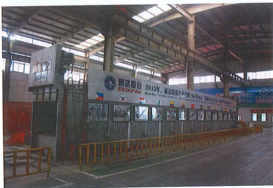
图 2-4 厂区设备照片
