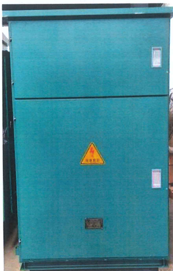
落地电力计量装置
