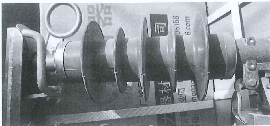
10KV 高压避雷器
